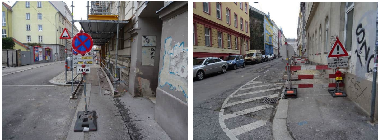
Abbildung 30 Stolperfalle Baustellengerüst und Umleitung
