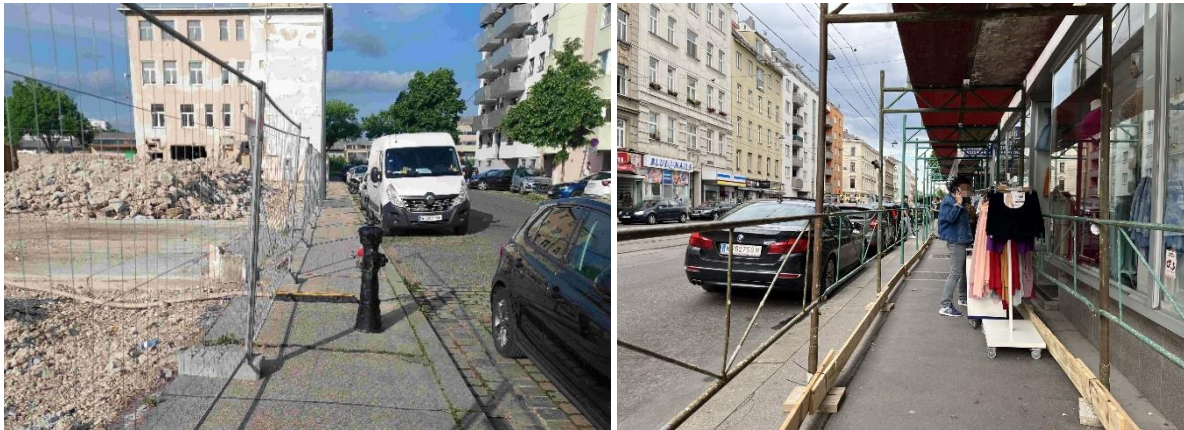
Abbildung 22 Einschränkung für den Fußverkehr durch Baustellen, z.B. Adolf-Gstöttner-Gasse, Wallensteinstraße
