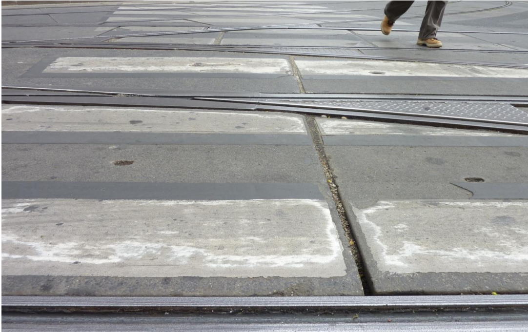
Abbildung 11: Schwer berollbare Oberfläche bei Schienenanlage
