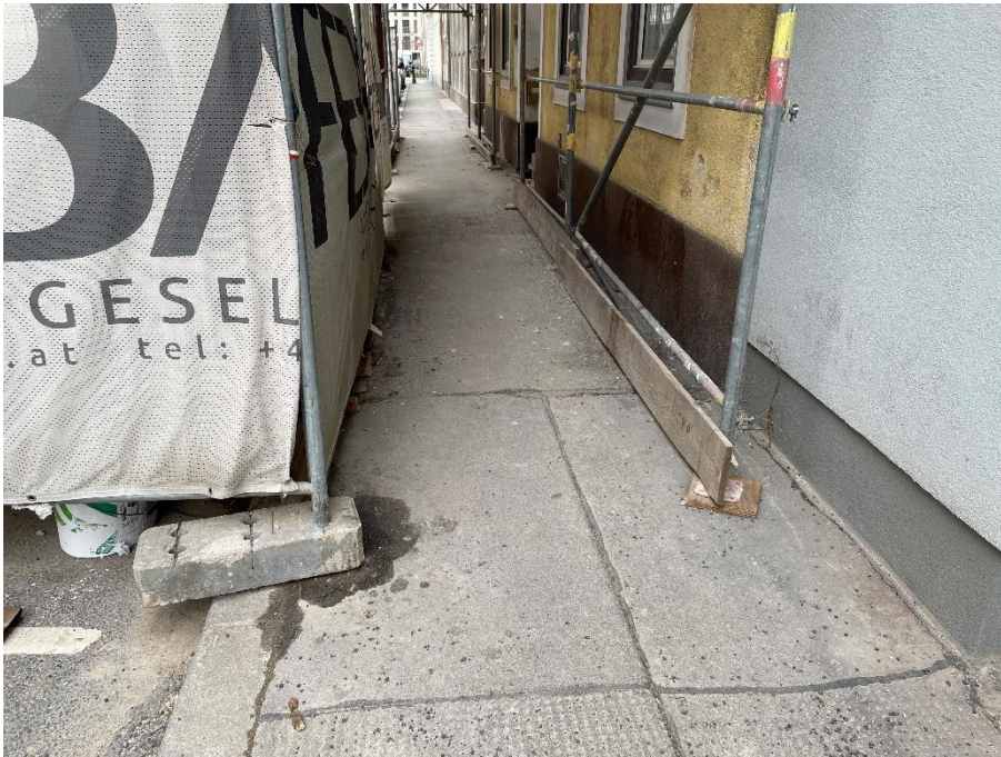
Abbildung 18: Tastleisten im Passagengerüst auf Bodenniveau
